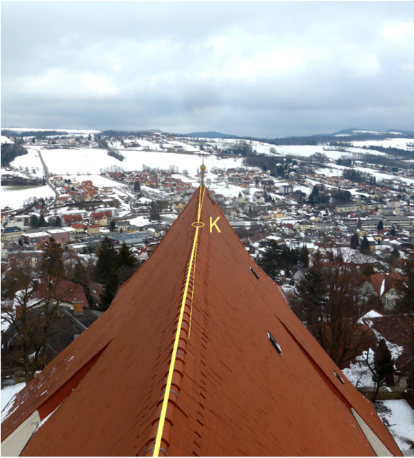
Abb. 21: Pfarrkirche Friedberg, Achsknick am Dachfirst erkennbar (K = Knickpunkt)
