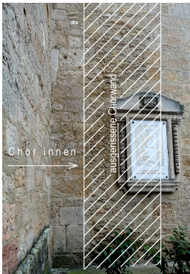
Abb. 36: Pfarrkirche Fischau, ausgerissene Wand des Chorquadrats
