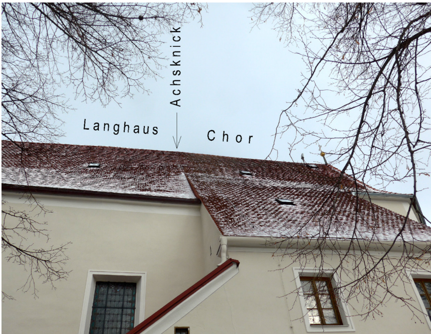
Abb. 20: Pfarrkirche Friedberg, Achsknick am Dachfirst von unten gesehen (zeigt nach Norden)
