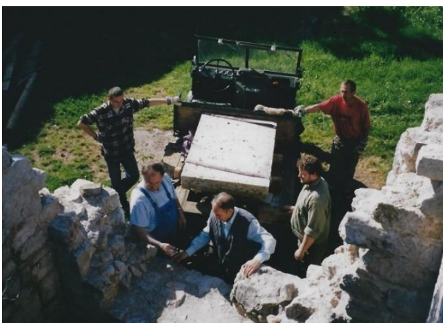
Abb.38: Herbert Hochhauser, Leopold Grund und Martin Schmölz (alle im Vordergrund) überlegen wie die angelieferte Mensaplatte am 17. Mai 2001 mittels UNIMOG des Martin Schmölz am besten über die südliche Chorwand an ihren Bestimmungsort (Altarsockel) geschafft werden kann.
