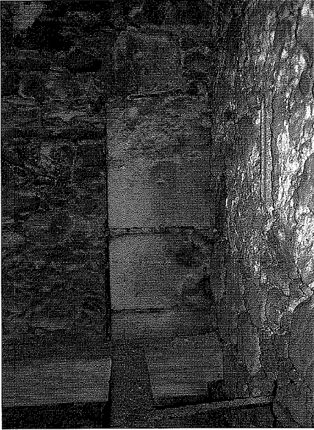
Abb. 56: Linz, Stadtpfarrkirche, gotischer Strebepeiler mit Wasserschlag in der Nordwand des Mittelschiffes im Bereich der Triumphpforte (Dachboden Seitenschiff, sichtbare Breite 0,55 m, offene Baufuge ca. 0,40 m) (Foto: E. Reidinger).
