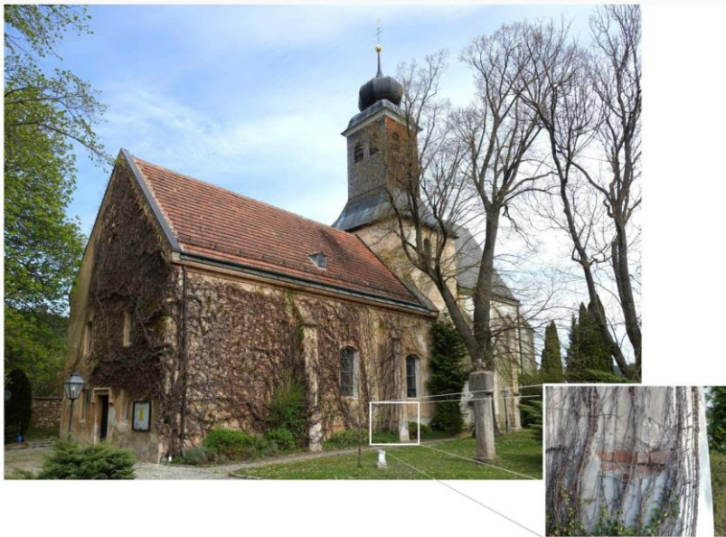
Abb.17: Pfarrkirche Muthmannsdorf, Ansicht von Südosten mit zwei Strebepfeilern als nachträgliche statische Maßnahme (Detail: Pfeiler aus Ziegelmauerwerk)
